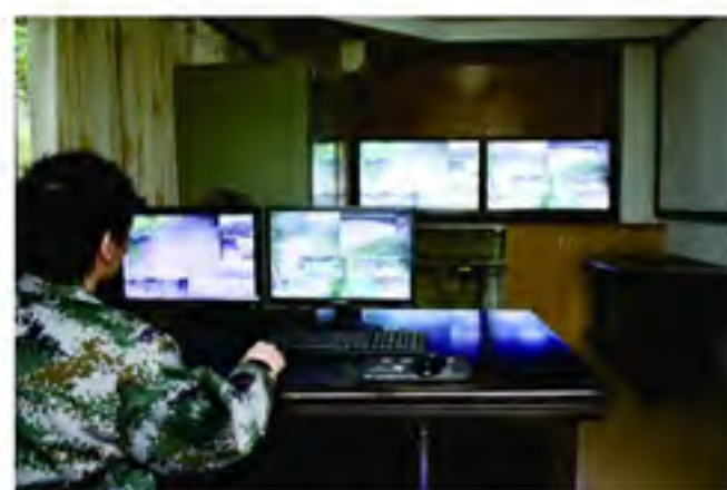
无线视频监控室
